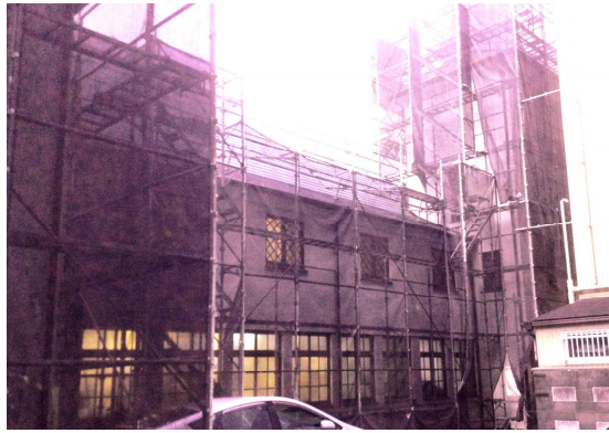
塔まで組まれた足場 ひびが増えつつある
